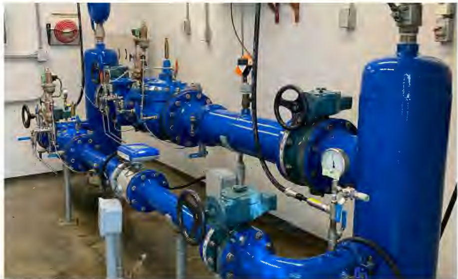
Inside a PRV
